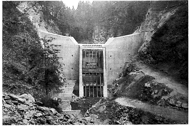
Bild 4. Die Palanggenbachsperre von oben. Im Rechenvorbau erkennt man die je fünf Rechenstäbe, die auf durchlaufenden Auflagerbalken liegen.
