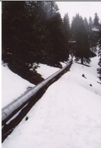
Bestehende offen geföhrt Druckleitung (D = 0.55 m)
