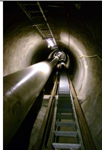
Neue Druckleitung im schrägschacht mit Inspektionsaufzug
