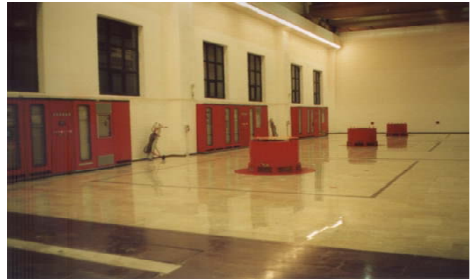
Kraftwerk – Maschinensaal mit 3 Gruppen und Steuerschränke
