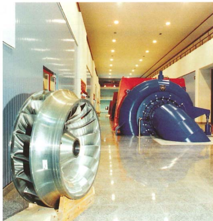
Zentrale Unteraa: Maschinensaal Centrale Unteraa: sala macchine
