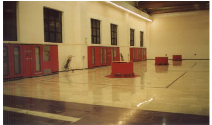
Centrale hydroélectrique, salle de machines avec 3 groupes et armoires de manœuvre
