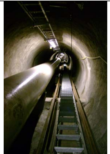
Neue Druckleitung im schrägschacht mit Inspektionsaufzug
