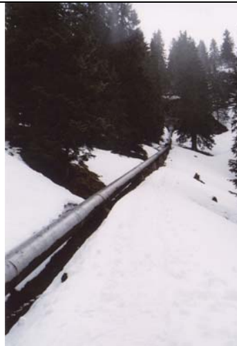
Bestehende offen geföhrt Druckleitung (D = 0.55 m)
