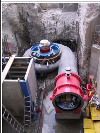
Francisturbine mit Abschlussorgan
