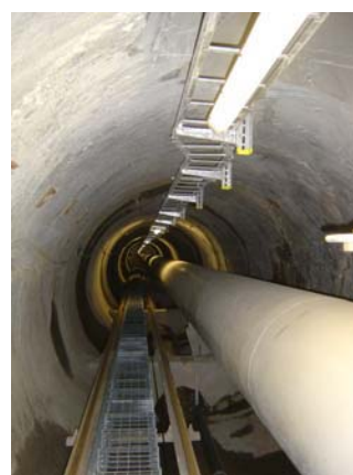
Nouvelle conduite forcée dans puits incliné avec rails du funiculaire d'inspection
