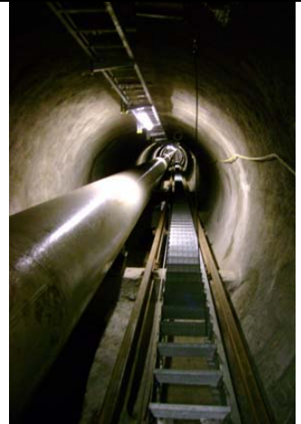
Nouvelle conduite forcée dans puits incliné avec rails du funiculaire d'inspection
