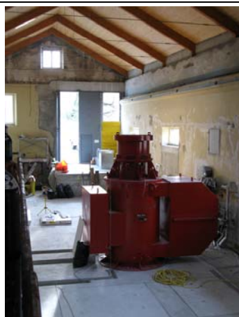
Generatore sincro 2.4 MVA
